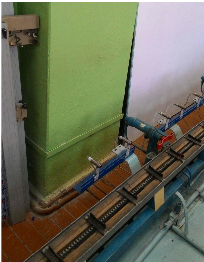
Рисунок 2.13 Стальная полоса, огибающая колонну — шина заземления.
