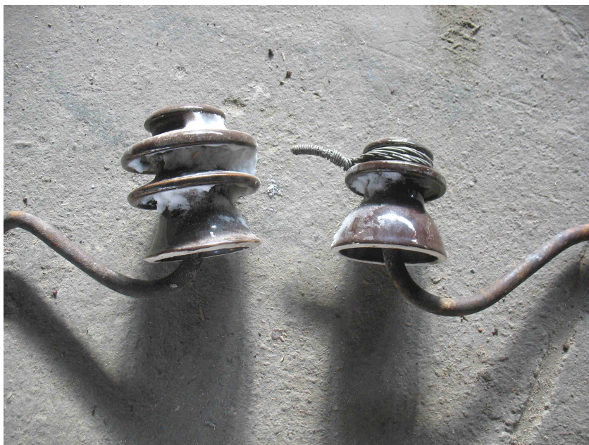
Рисунок 6.4 Фарфоровые изоляторы линий электропередач. Между фарфоровым изолятором и стальным крюком втулка из полиэтилена, для защиты фарфора от трещин. Дисковая форма изоляторов позволяет воде стекать не образуя сплошного слоя, замыкающего проводник на опору. Фарфоровые изоляторы, в отличие от стеклянных, непрозрачны, что затрудняет визуальную проверку изолятора на наличие трещин.
